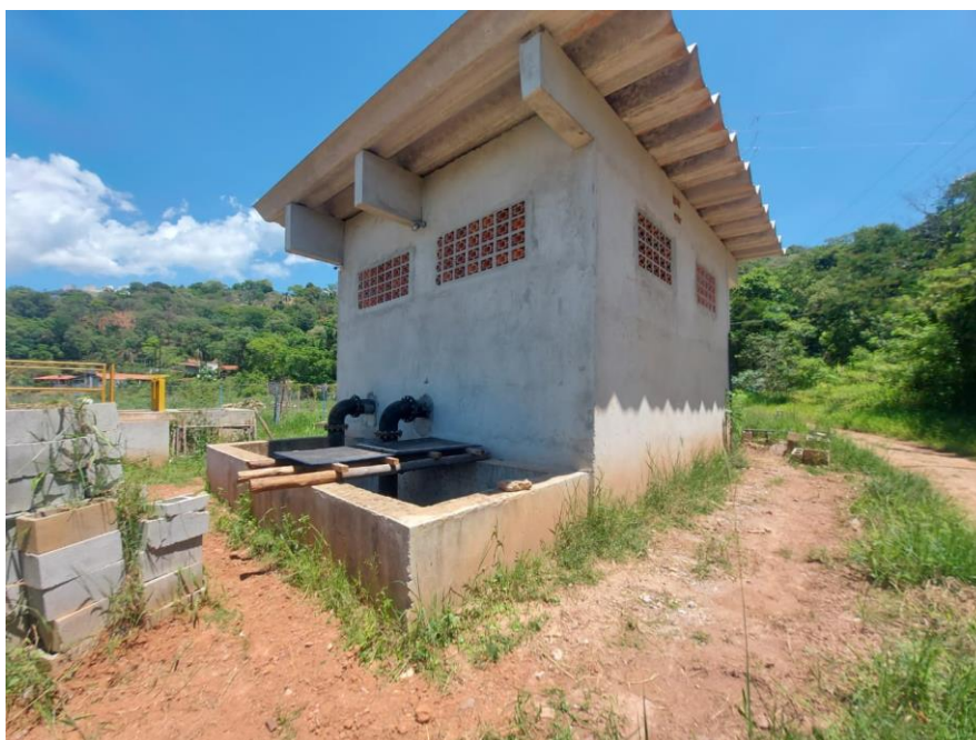
Foto 3 – Casa de Bombas nova Captação
