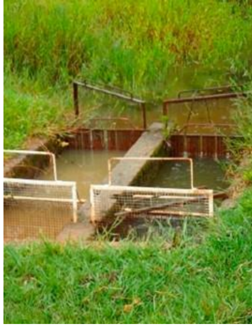
Foto 1 – Detalhe do gradeamento da captação
